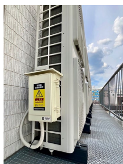
空調機自動制御
