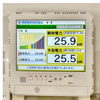
デマンド監視装置
