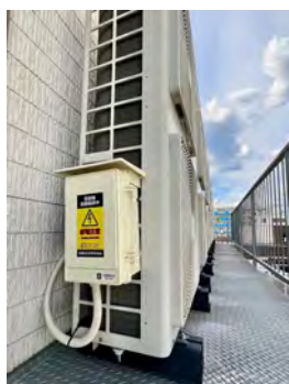
空調機自動制御
