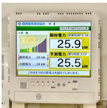
デマンド監視装置
